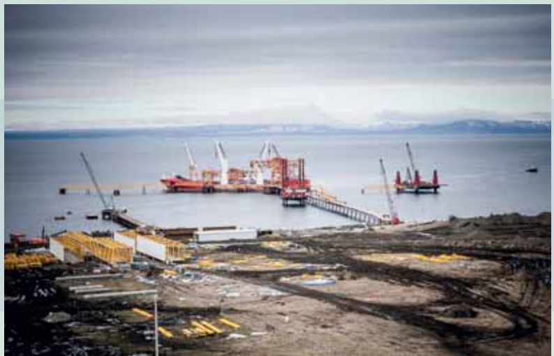
Vista general de la obra desde tierra, de derecha a izquierda se ve la plataforma Jack up Belfi III construyendo poste de amarre, plataforma Jack Up Belfi VI montando estructura en puente de acceso, buque de montaje trabajando en cargadores y muelle de servicio con grúa de 150 toneladas.
