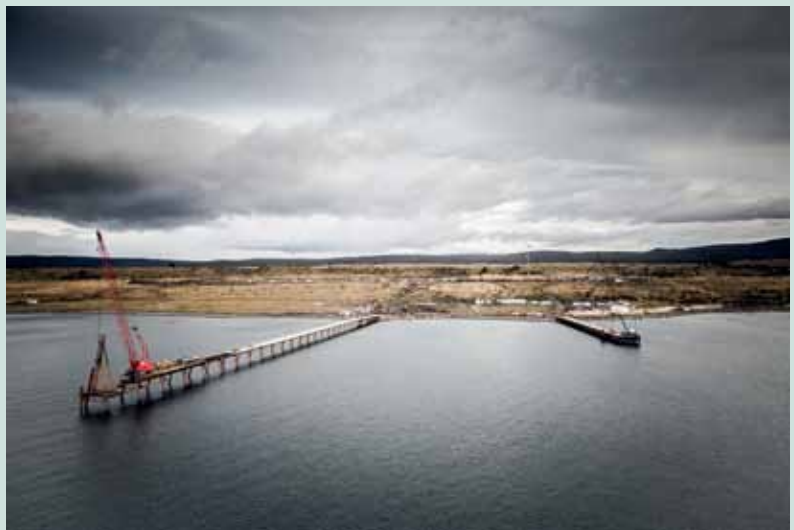
Frente de trabajo con grúa avanzando desde tierra (a la izquierda) y el muelle de servicio usado para trasladar insumos a los frentes marítimos (a la derecha).
