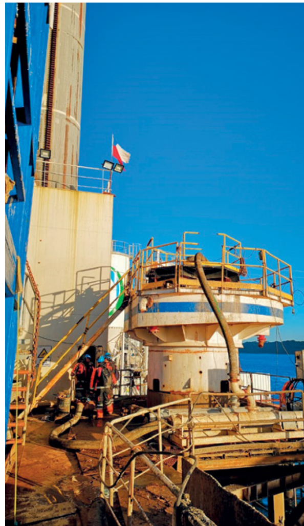
El tamaño y los grandes volúmenes de los pilotes y distintos elementos de hormigón que tiene la Pila Central, requieren la implementación de una planta de hormigón offshore, instalada en una plataforma ubicada en la zona de Roca Remolino.
