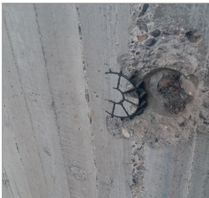
INSTALACIÓN INCORRECTA DE SEPARADOR DE ENFIERRADURA
