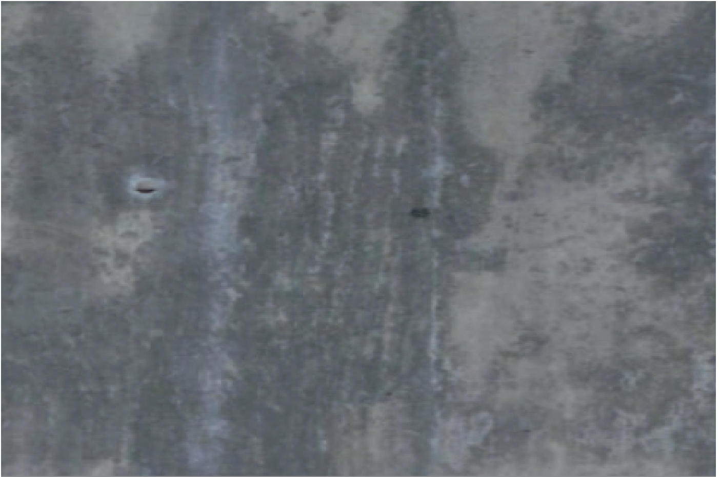
Esta imagen muestra una superficie manchada, no aceptable para hormigón arquitectónico
