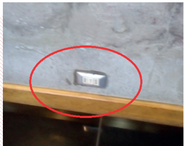
Caja de enchufe mal terminada en pared de hormigón arquitectónico.
