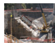
Central de paso higueras
