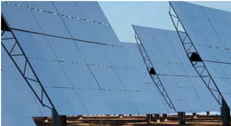
El proyecto tendrá 10.600 heliostatos, con una superficie reflectante de 140 metros cuadrados cada uno.
