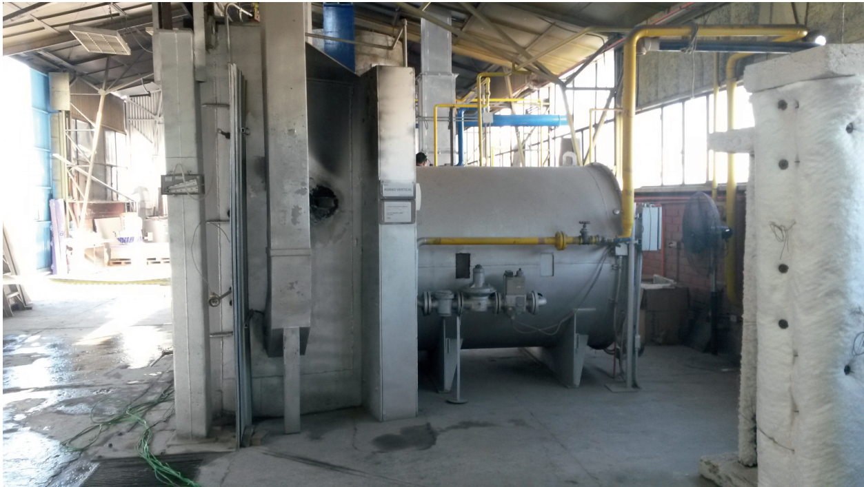
Figura 2.3. Equipo de ensayo resistencia al fuego.
