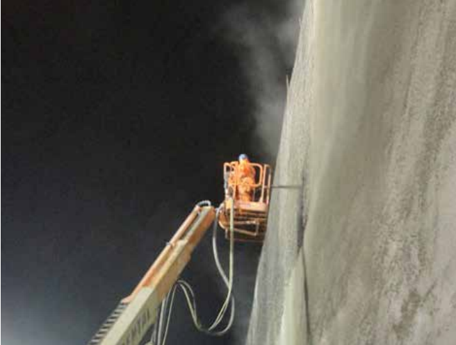
Figura 9.19a Aplicación de shotcrete manual en talud y muros de contención, sobre equipos de levante.
