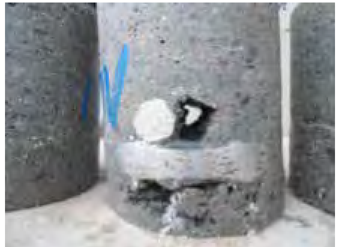
Figura 2.4 Testigos que demuestran el mal encapsulado de las barras, parte del proceso de examinación del ACI 506.
