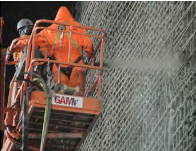
Figura 9.19b Detalle de aplicación de shotcrete manual sobre equipos de levante en superficie.
