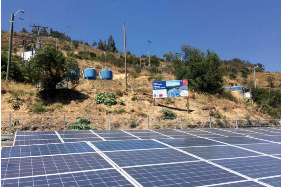
Para proyectos a baja escala, el retorno de la inversión solar se recupera entre cinco y siete años. Proyecto de bombeo fotovoltaico en el centro norte del país.
