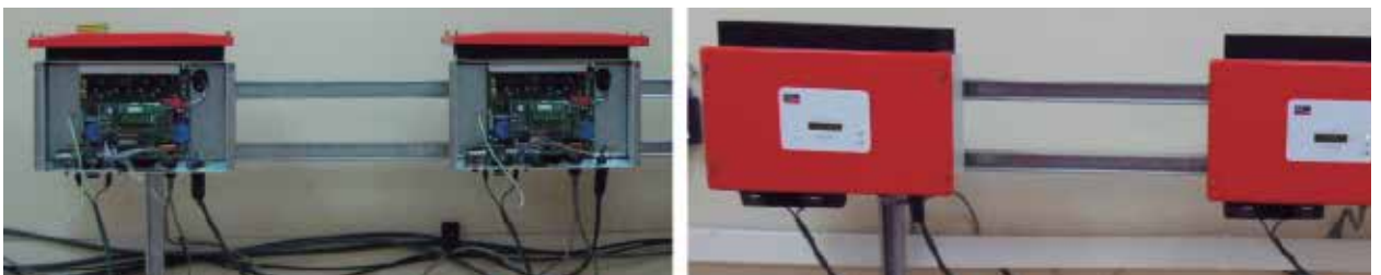
FIGURA 3.10 Instalación y Conexión del Inversor. Se aprecia la distancia entre cada inversor, para una correcta ventilación. Fuente: Proyecto de Generación Fotovoltaica Chilectra-UTEM.
