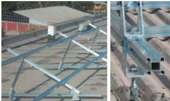
FIGURA 3.6 Estructura de Soporte. En el detalle se aprecia el perno de anclaje. Fuente: Proyecto de Generación Fotovoltaica Chilectra - UTEM.
