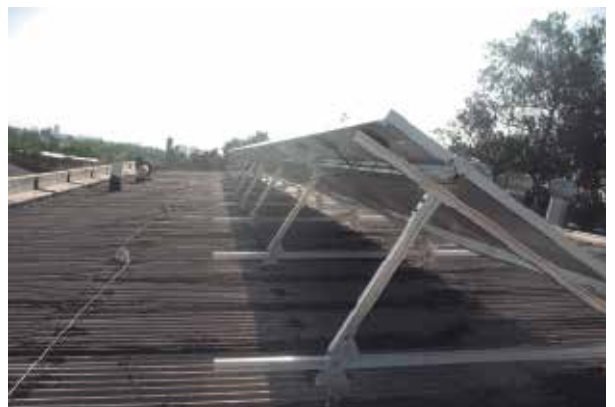
FIGURA 3.7 Detalle del Montaje de los Módulos. Se aprecia el montaje en la estructura, sin realizar las conexiones eléctricas. Fuente: Proyecto de Generación Fotovoltaica Chilectra - UTEM.
