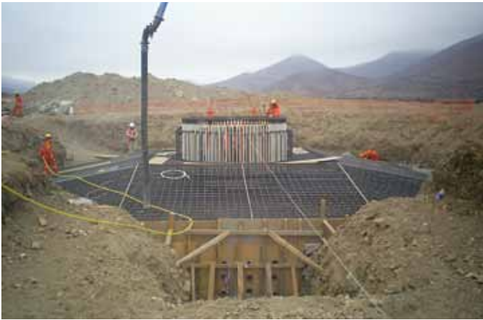
Las fundaciones son octogonales y en cada una se utilizaron 240 metros cúbicos de hormigón y 33 toneladas de fierro.
