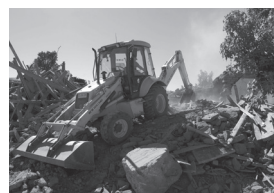
▲ Demolición post terremoto por las máquinas retroexcavadoras. Fuente: fotografía Equipo UC, marzo 2010
