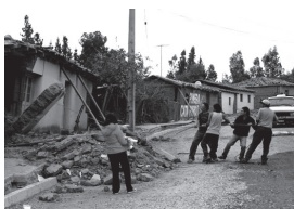
▲ Vecinos demoliendo sus viviendas de adobe. Fuente: fotografía Cristián Yáñez Ilabaca, marzo 2010
