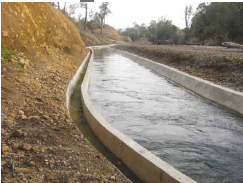
Canal de aducción de la mini-hidro Cuchildeo.
