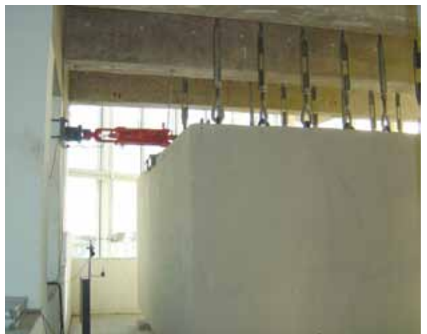
Figura 25. Aplicación amortiguador AMS. 1 EDIFICIO PARQUE ARAUCANO (CHILE)
