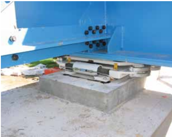
Figura 22. Aplicación disipador metálico en apoyo de puente.
