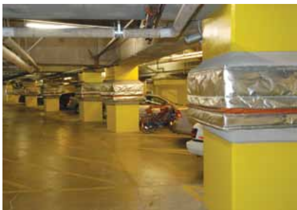
Figura 43. Protección contra fuego de aisladores sísmicos. CHANNING HOUSE CALIFORNIA (EEUU)
