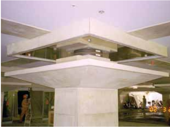
Figura 34. Aplicación apoyo deslizante. HOSPITAL TAKASU (JAPÓN)
