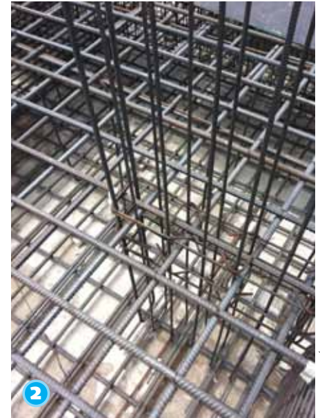
1. Proyecto con los nuevos criterios del decreto (confinamiento de puntas de muro). 2. Muro de proyectos antiguos de similares características pero donde no se aplicaban criterios tan exigentes.
