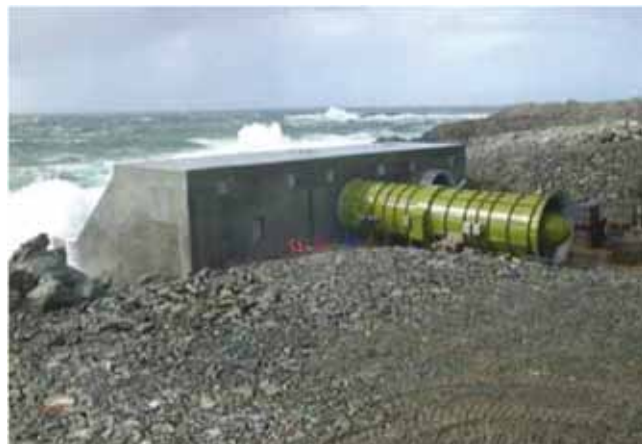
Se observa uno de los dispositivos que aprovecha la energía undimotriz. Se trata de Limpet 500, tecnología instalada en la isla escocesa Islay.
