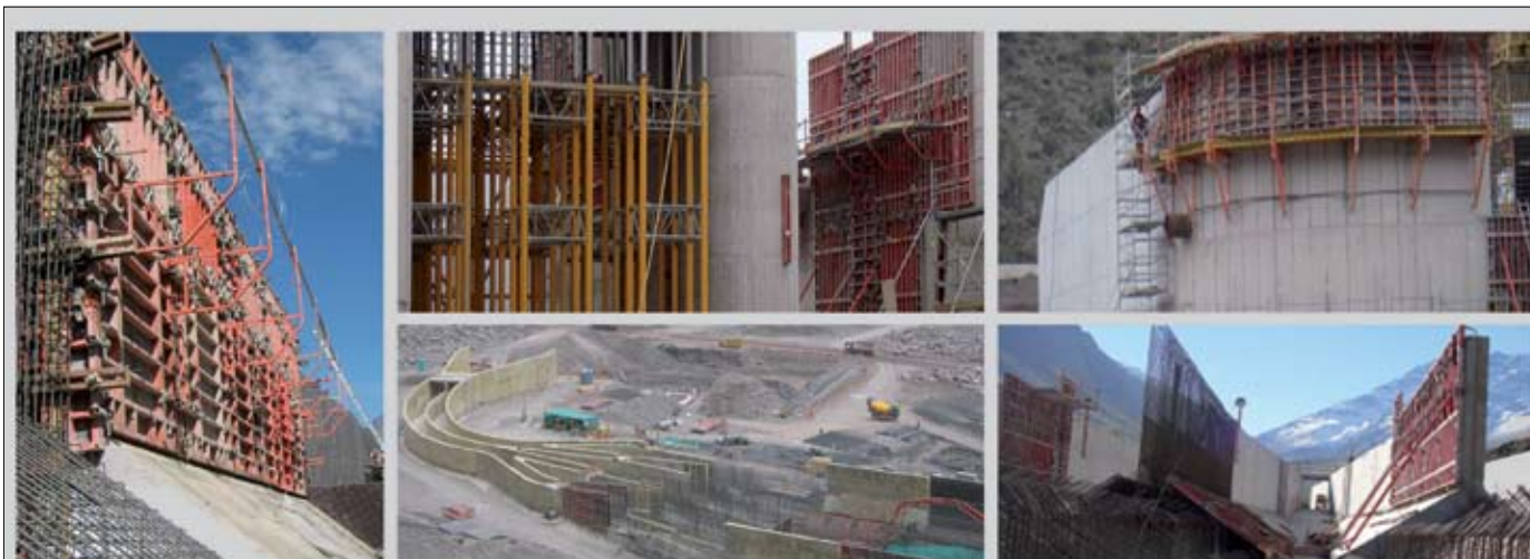
CENTRAL HIDROELÉCTRICA CONFLUENCIA
