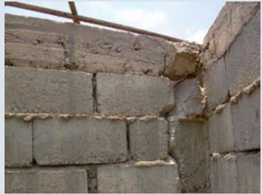
En Arica, Iquique y Antofagasta, es vital revisar la construcción en albañilería de bloque. En el detalle se muestra un muro medianero dañado en el terremoto de Tocopilla de 2007.
