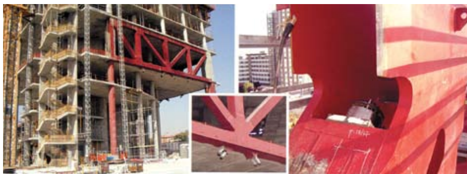
TORRE ESPACIO. En la planta 4 se ubican las vigas de carga que soportan los pilares de las fachadas sur y este. Se componen de perfiles de acero con diagonales postensadas.
