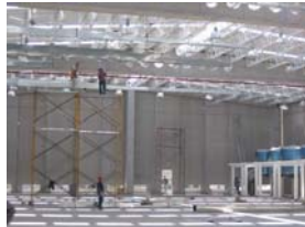
Construcción Industrial Liviano
