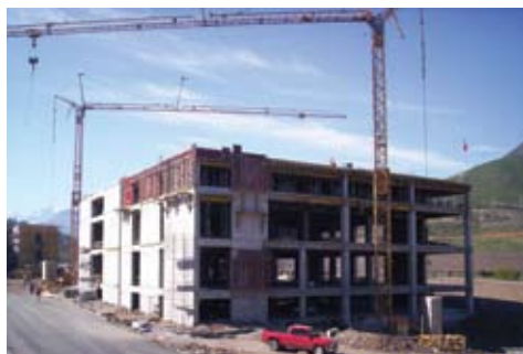
Obra Zona Centro Costa: Puerto Terrestre de Los Andes. Constructora AZM Chile S.A.
