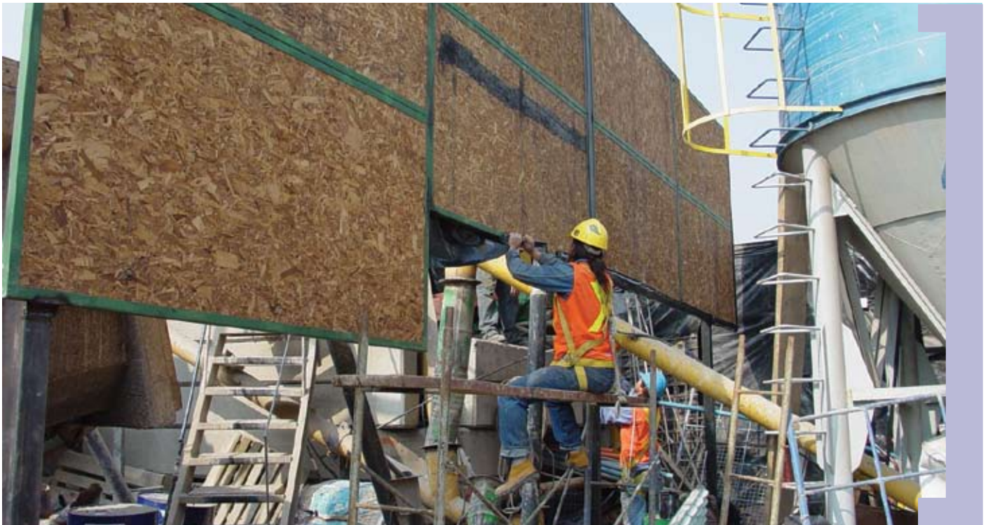
Las barreras acústicas emplean distintos materiales como planchas de OSB. Además, al interior se pueden reforzar con elementos aislantes como lana mineral.
