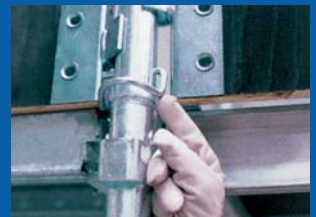
Colocar los pasadores de seguridad y amarrar la estructura a la fachada, al puntal, a la ventana.
