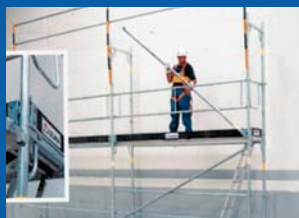
Colocar las diagonales. A partir del segundo nivel los enganches son a punto fijo.
