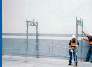
Base de paso: las tuercas del husillo dejarlas paralelas al sentido de circulación peatonal o colocarles protectores.
