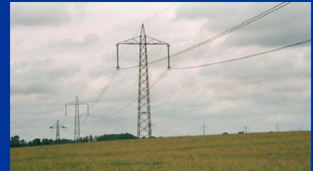
Una línea HVDC \pm 500 o \pm 600 kV
