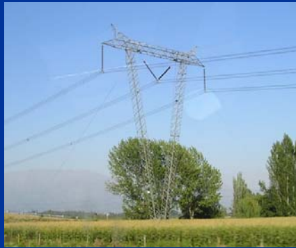
Dos líneas HVAC 500 kV
