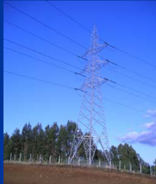
Dos líneas HVAC 220 kV
