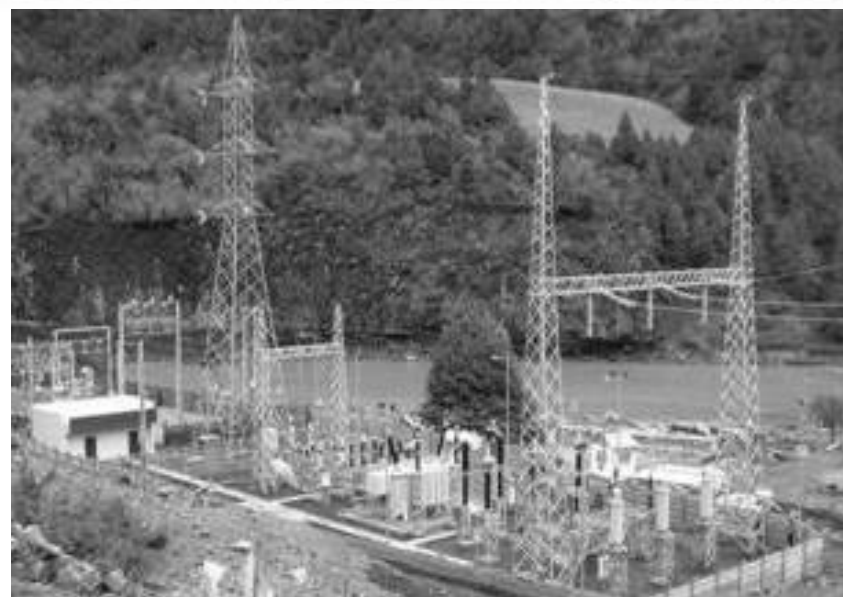
Subestación zona de caída
