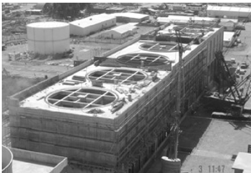
Vista general torre de refrigeración
