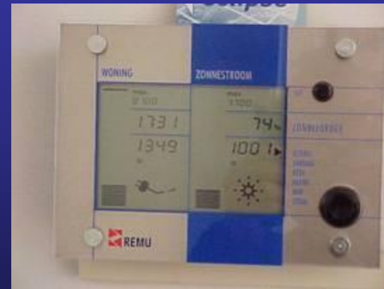
Medidores Entrada y Salida
