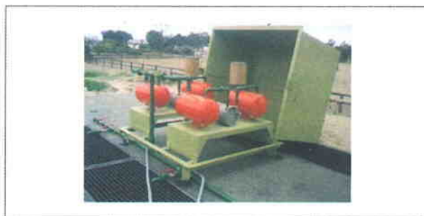
Ilustración 5 Instalaciones para tratamiento de agua
