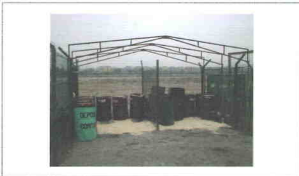
Ilustración 24 Almacenaje de combustibles
