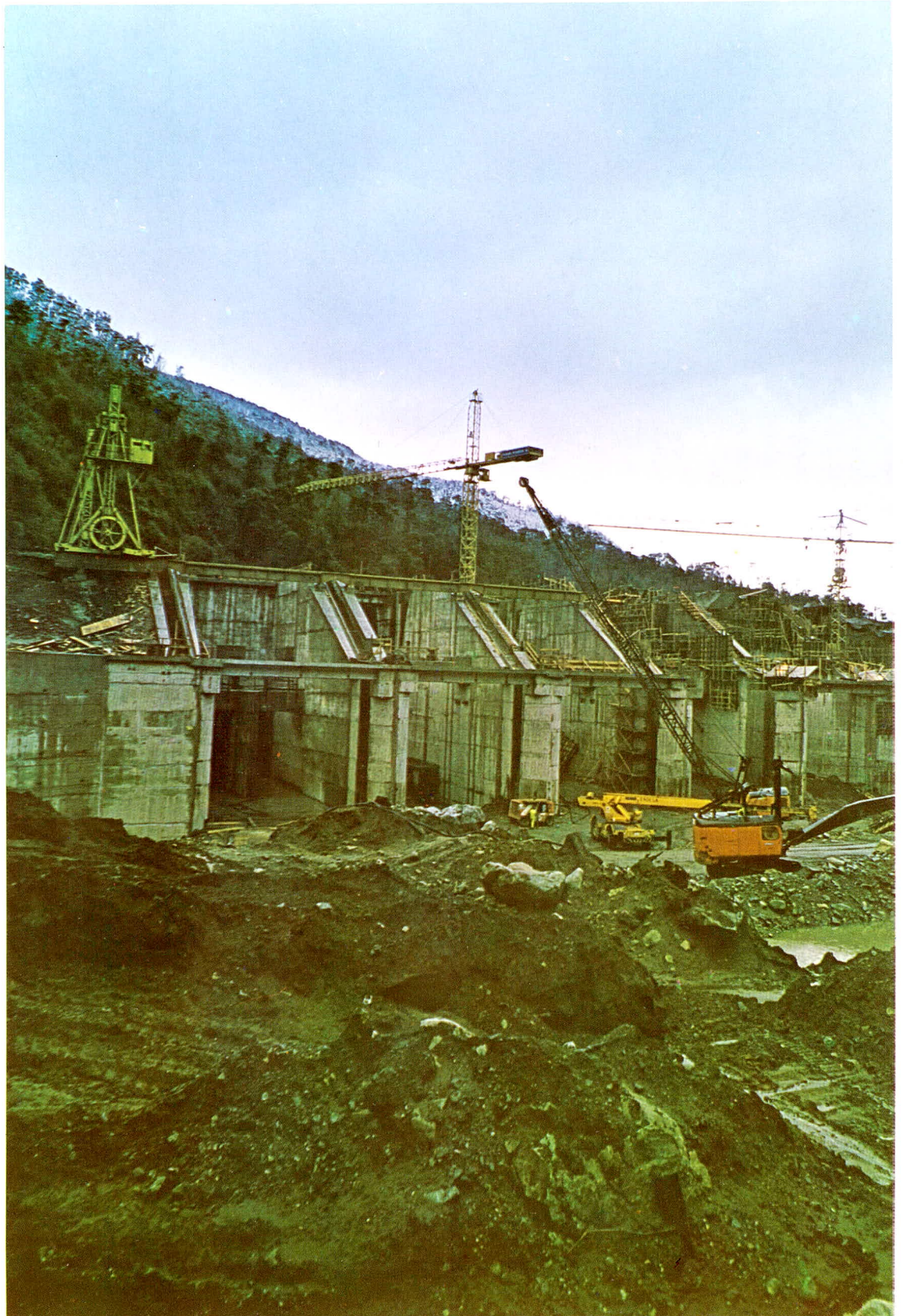
Foto 3 Bocatoma Polcura. Central Antuco.
