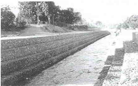
Fig. N°2.10 Protección y peraltamiento de ribera con gaviones
