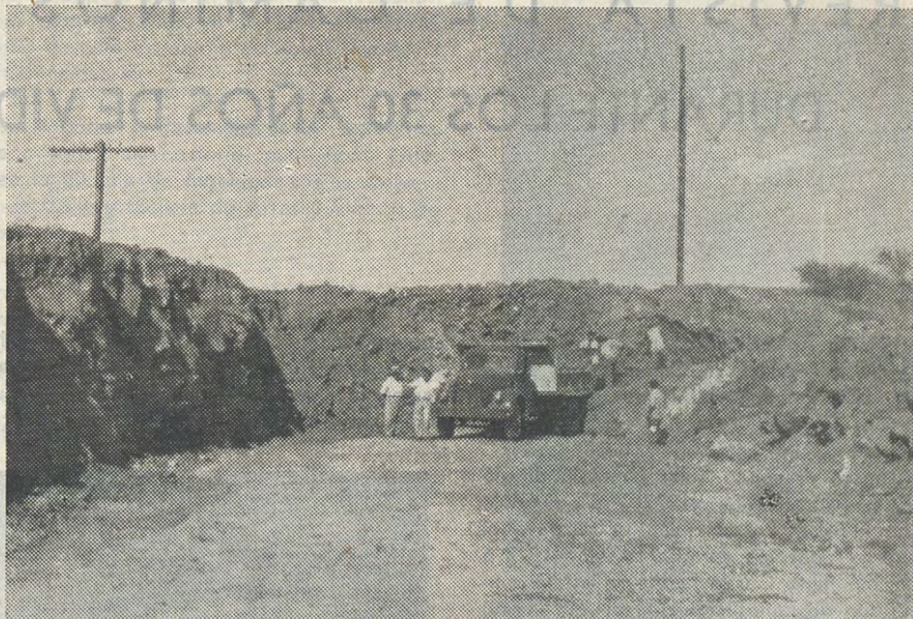
SECTOR DONIHUE A COLTAUCO, KM. 24,1. Camiones de la Empresa Gidi en el corte La Cruz, cargando roca y que será colocada en terraplenes de este sector.
