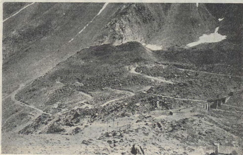
En el Km. 62 se está construyendo una variante en el camino. La vista muestra las obras del nuevo trazado, que pasará por la orilla de la Laguna del Inca y del Hotel Portillo.
