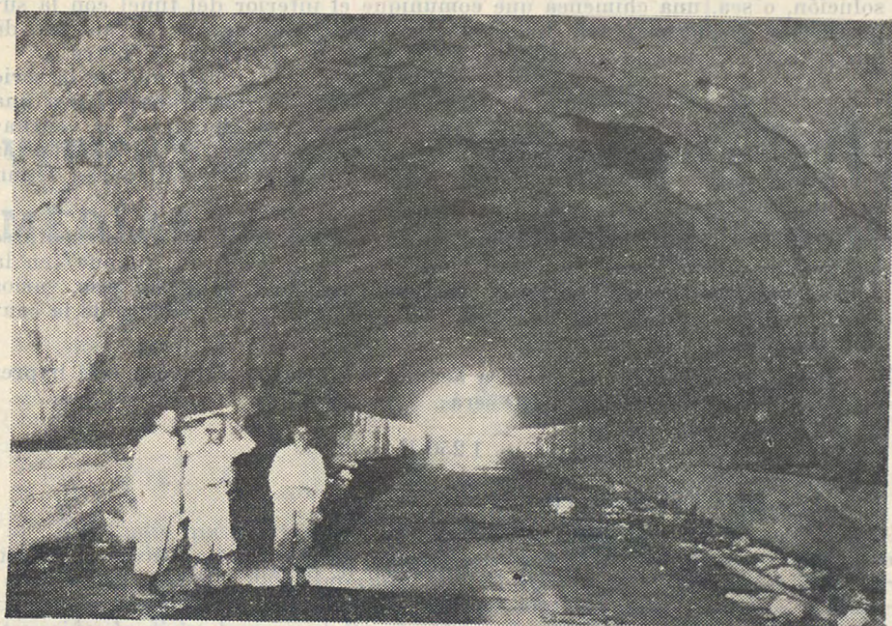
Esta vista interior del túnel en terminación, nos muestra dos tipos de muros: los altos son los soportantes del arco de la bóveda y los bajos los guías que se construirán en la mayor parte central de esta obra.
