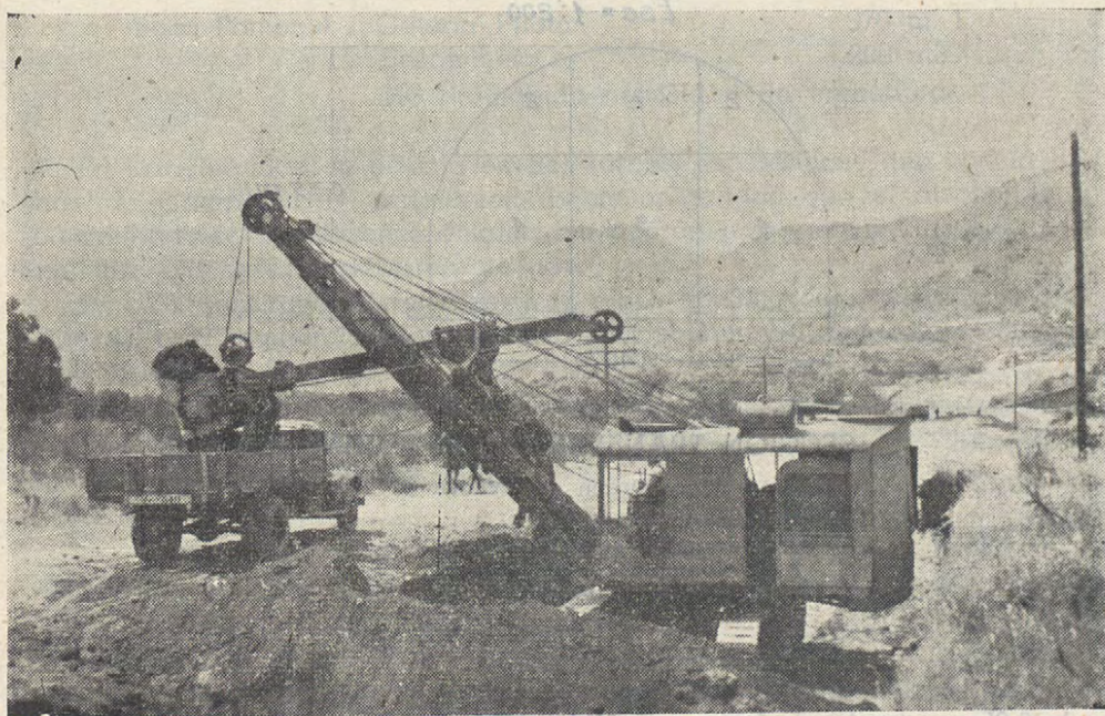
Pála mecánica trabajando en los terraples del camino del Túnel de Zapata a Casablanca.
