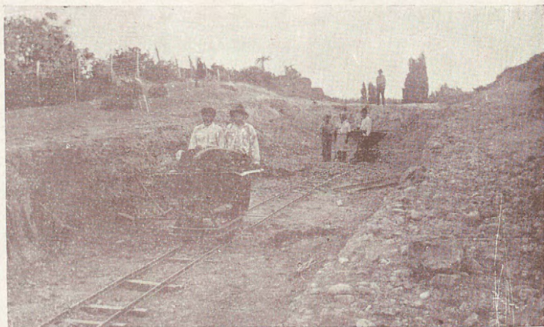
CORTE CERRO EL MOLINO. CAMINO DE SAN JAVIER A VILLA ALEGRE EN CAMINO LONGITUDINAL
