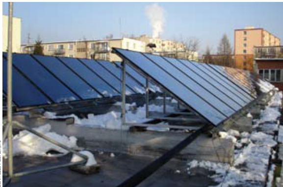
Instalación solar colectiva con colectores Genersys resistentes a temperaturas bajo cero, granizos y nieve.
