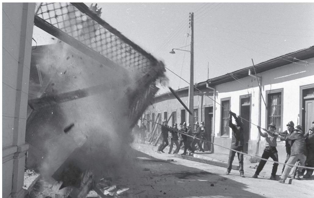
Demolición de una estructura tras el terremoto de 1960. Imagen de un grupo de bomberos derribando con cuerdas la fachada de una construcción tras el terremoto de 1960. Fotógrafo Jack Ceitelis.
