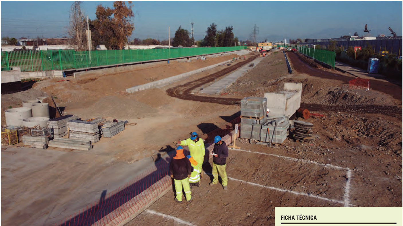
El proyecto consiste, principalmente, en la ejecución de las obras civiles para la unión completa del acueducto del parque inundable.
