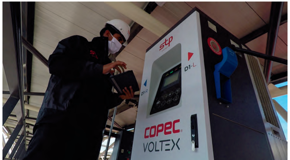
La seguridad para el personal es uno de los atributos del electroterminal ubicado en Maipú.
