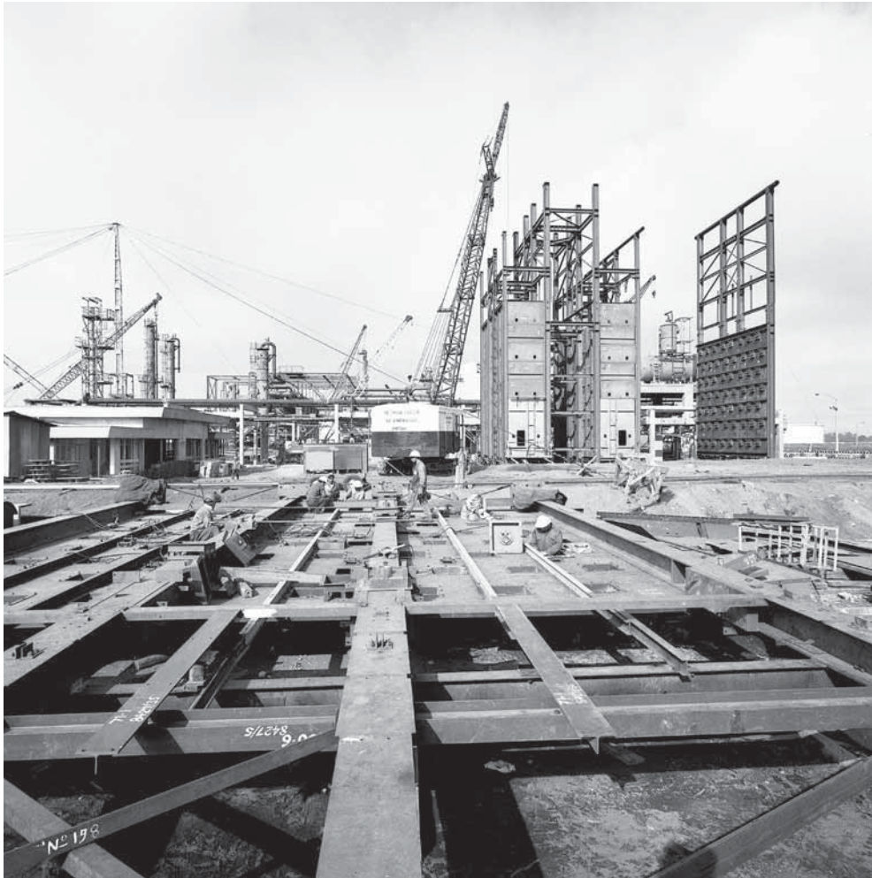
Montaje de la refinera Aconcagua, 1969. Imagen general de las faenas de montaje de la refinera de petrleo Aconcagua en Concón, Región de Valparaíso. Obra realizada por la empresa Ovalle Moore. Fotógrafo Jack Ceitelis.
