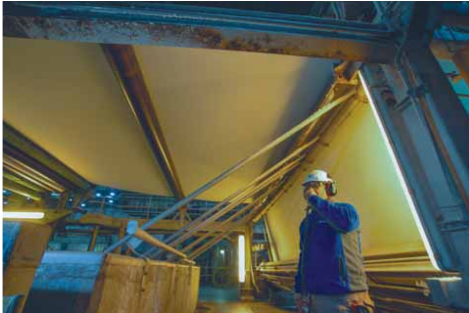
Imágenes de la sala de máquinas actualmente en operación de la Planta Valdivia.
