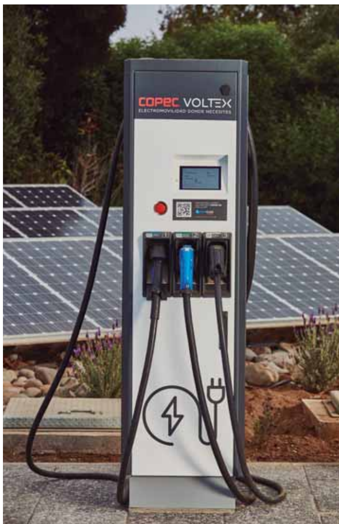
Copec tiene una red de 23 puntos de abastecimiento eléctrico en la zona central.
