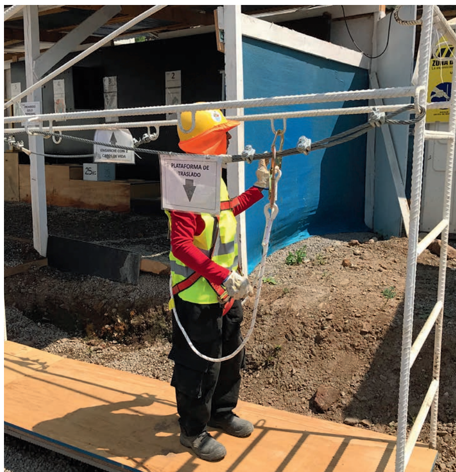
Imagen del circuito de entrenamiento práctico de “Aprender Ejecutando” de Echeverría Izquierdo Edificación. En este caso, busca instruir a los trabajadores sobre el uso correcto del arnés de seguridad y el posicionamiento en la plataforma de trabajo en altura.
