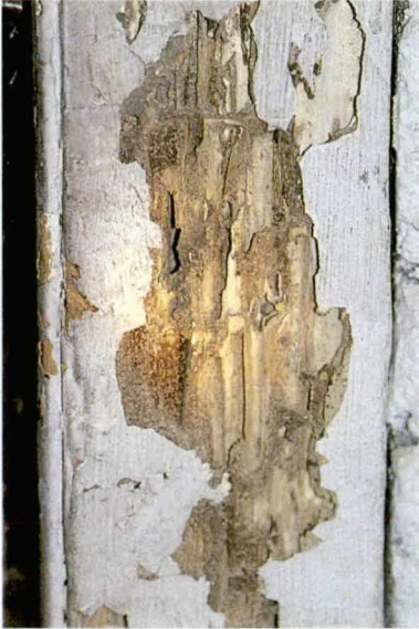
Daño producido por termitas subterráneas en el marco de una puerta.
