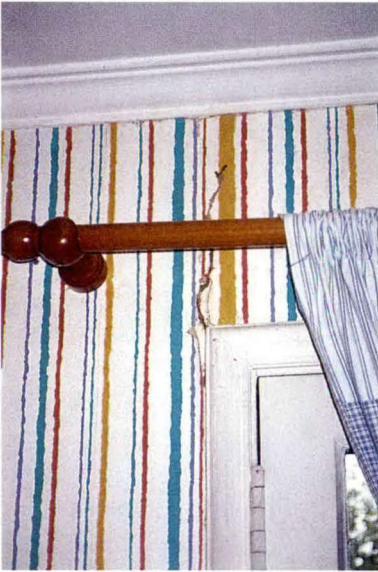
Túnel de comunicación saliendo de marco de puerta y daño en papel mural.
