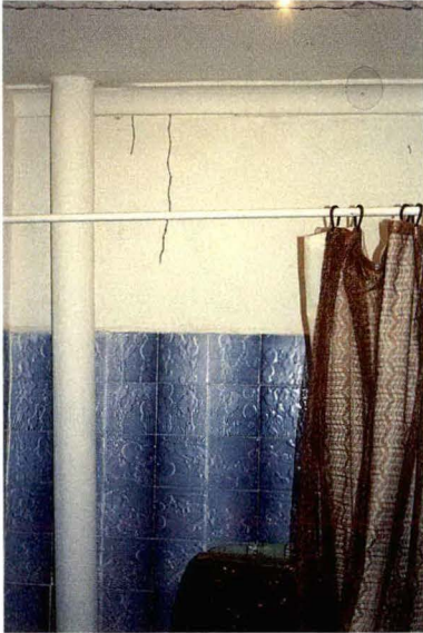
Tubo de comunicación de termitas subterráneas emergiendo desde cañerías de baño de una vivienda.
