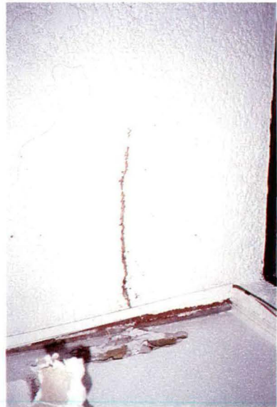
Daño en cornisa y entretecho con túnel emergiendo hacia abajo.
