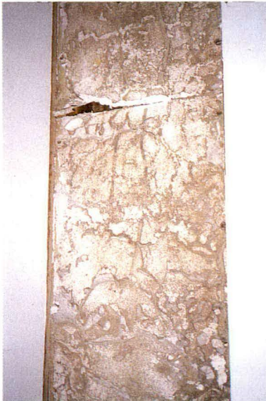
Daño en plancha de yeso-cartón.
