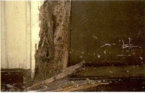
Daño producido por termitas subterráneas en marco de una puerta.
