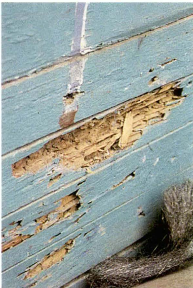
Daño producido por termitas subterráneas.
