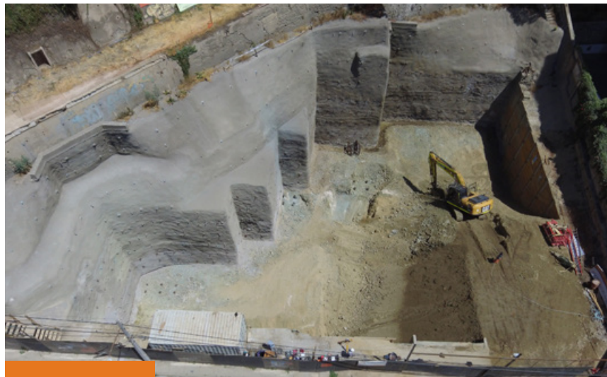
Edificio Vive Viana III - Viña del Mar / Cliente: Inmobilia / Tecnología: Soil Nailing
