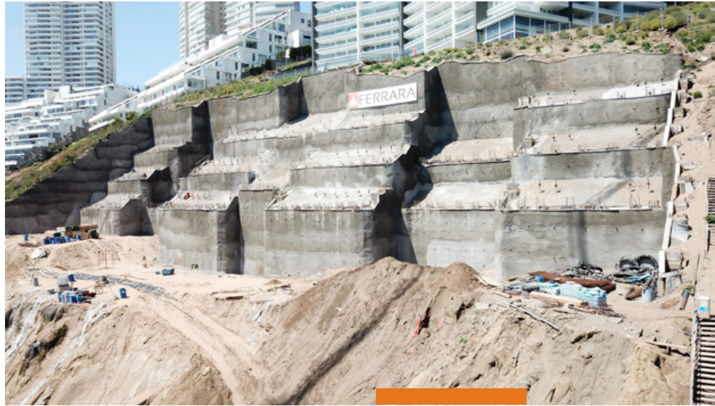
Edificio Mackroceano - Viña del Mar / Cliente: Inmobiliaria Makro / Tecnología: Llave en Mano (Excavaciones y Entibaciones)
