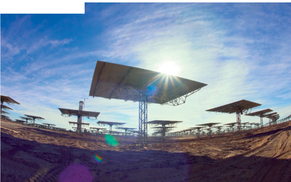
Cada heliostato está conformado por 32 espejos que siguen la trayectoria del sol con un movimiento en dos ejes.
