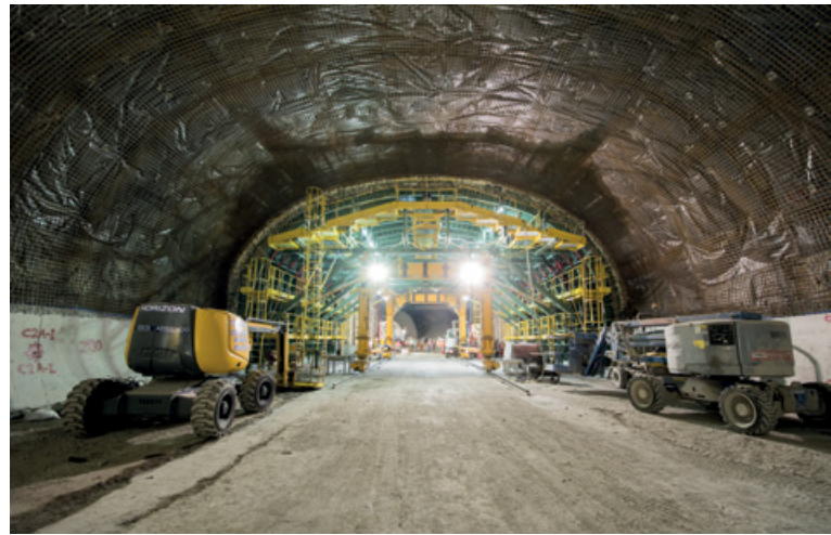
Carro de encofrado deslizante que ha permitido acelerar los trabajos de hormigonado del túnel Kennedy.
