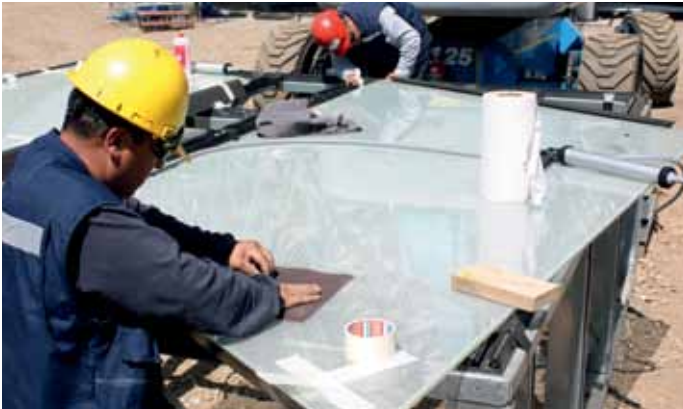
Preparación de los paneles de vidrio de las ventanas corridas, previo a su instalación entre las alas. A diferencia de los paneles de vidrio fundido, estos son transparentes.
