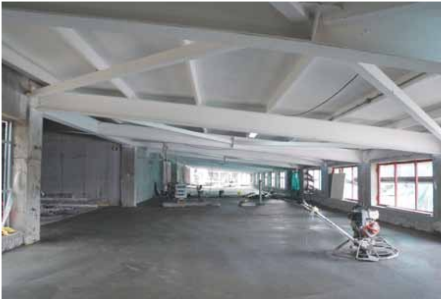
Se observa el piso mecánico con la cubierta que incorpora aislación térmica y la sobrelosa de piso con aislación acústica.
