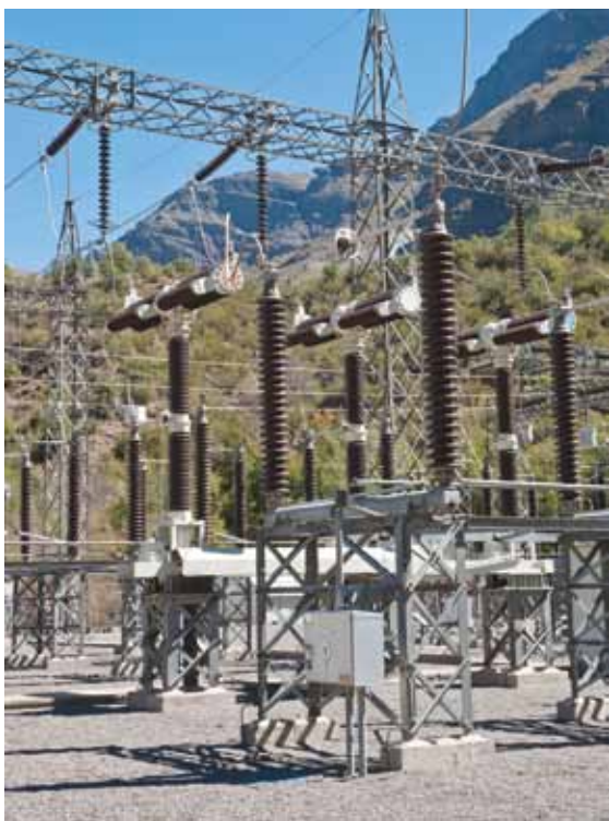
En el Proyecto Alto Maipo se consideran dos subestaciones, una a la salida de Las Lajas, bajo el concepto de una subestación encapsulada, es decir, dentro de un edificio, en tanto que Alfalfal II se conectará a la subestación de Alfalfal I (en la foto).
