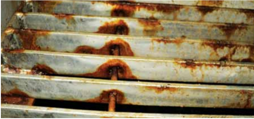
Grating de acero inoxidable contaminado con agua de mar. La acción de los cloruros acelera el proceso de corrosión, sobre todo si no se tiene cuidado con la estructura.
