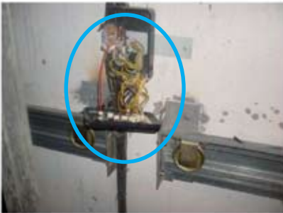
La caja eléctrica del shaft fue dañada, quedando expuesta a ser pasada a llevar por la cabina.
