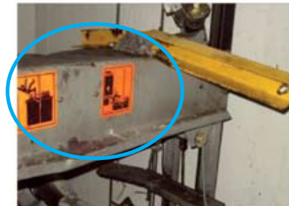
La suspensión de la cabina del ascensor fue dañada por el impacto.
