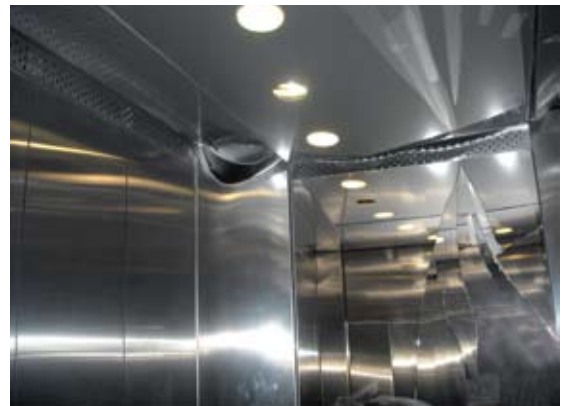
Cabina que presenta daños en su interior a causa de una colisión con el contrapeso.
