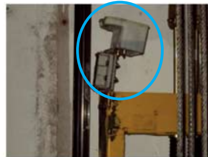
Daños en guidores y lubricadores de contrapeso.
