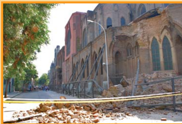
La Basílica del Salvador es hoy el ícono de las huellas que dejó el terremoto de 1985 y que en la actualidad se mantiene en pie mediante apuntalamientos por todo su perímetro.
