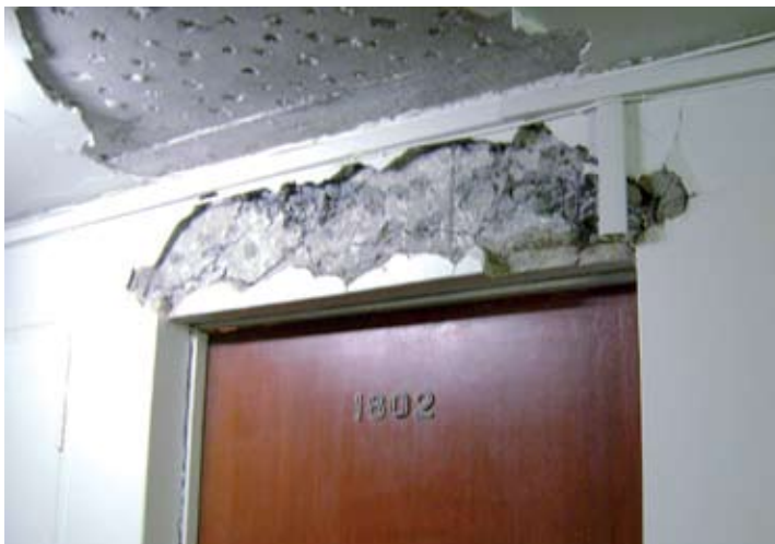
Falla de corte de dinteles de acoplamiento.
